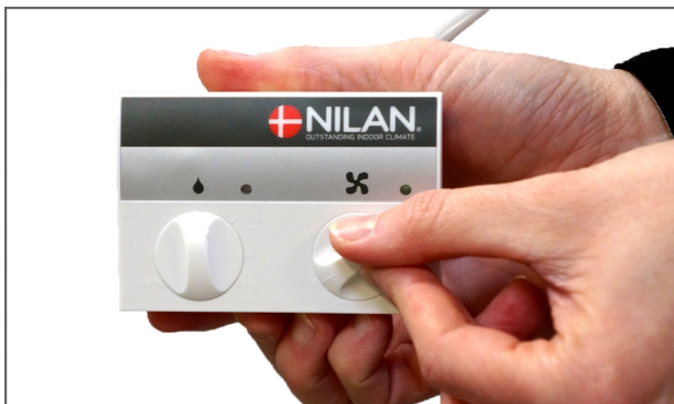
1. Der skal slukkes for aggregatet på betjeningspanelet inden lågen åbnes
